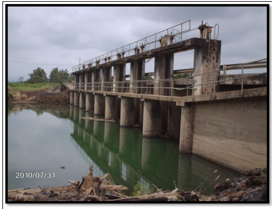
Figura 5. Compuertas para controlar el flujo de agua en verano del río las Juntas, Figure 5. Gates to control the water flow in summer of Las Juntas River, own source
