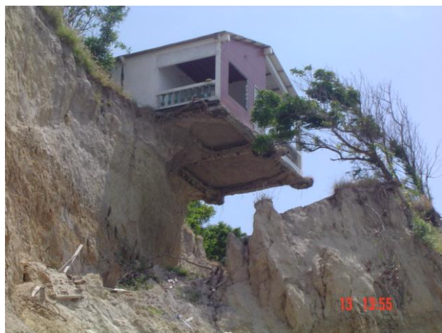
Foto 9.- Vivienda también afectada por la erosión.
